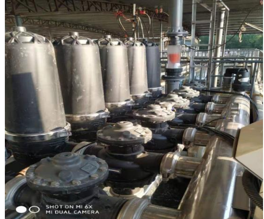
生化进水微滤器
