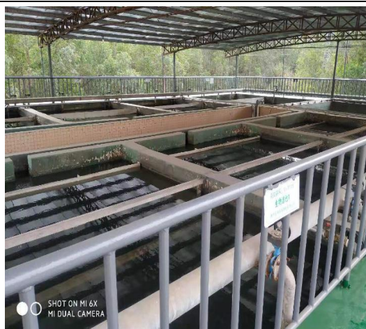
生物滤池控制系统
