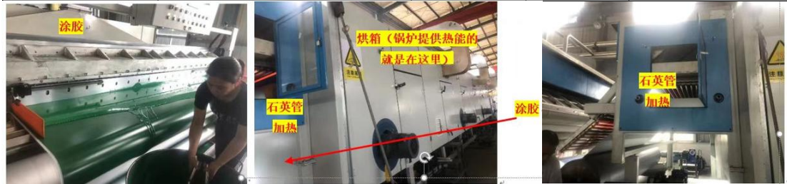
图 2-1 项目多功能 PVC 涂层机设备生产线
