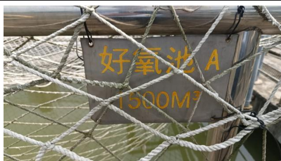
废水处理站好氧池 A
