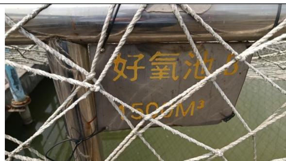
废水处理站好氧池 B
