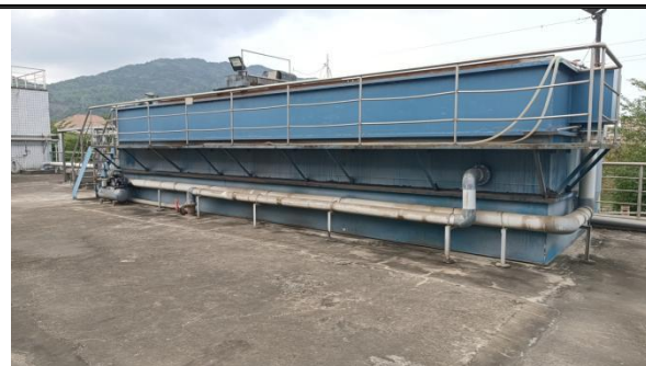
废水处理站气浮池
