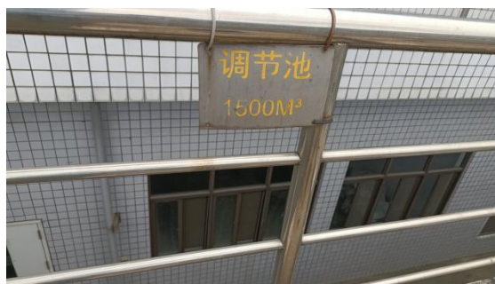
废水处理站调节池
