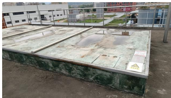
废水处理站厌氧池 A
