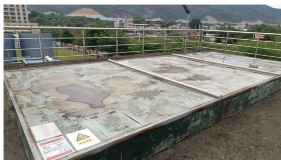
废水处理站厌氧池 B
