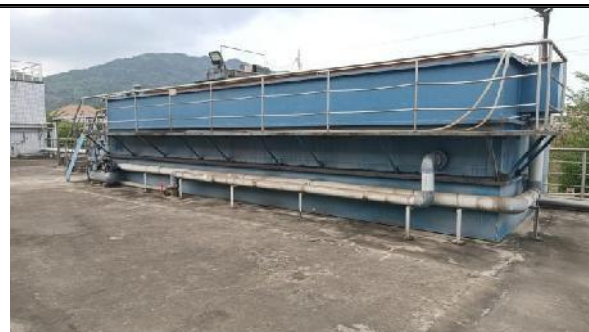
废水处理站气浮池
