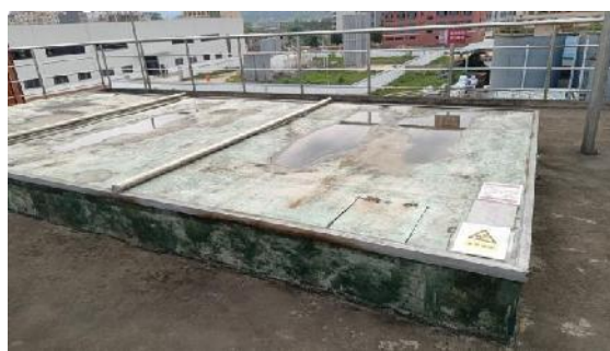
废水处理站厌氧池 A
