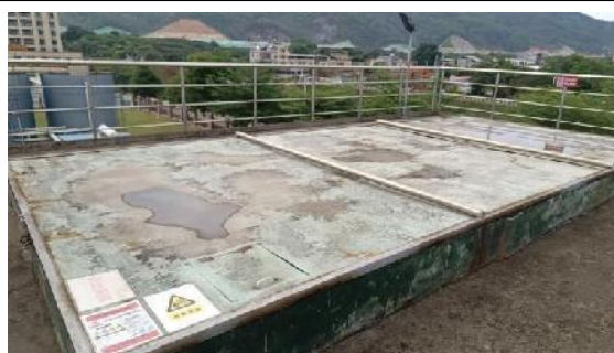
废水处理站厌氧池 B
