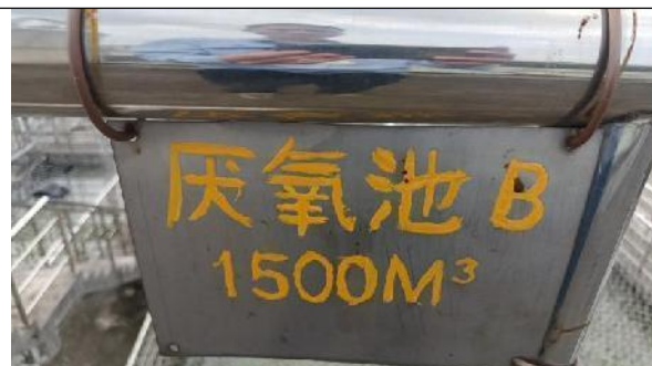
废水处理站厌氧池 B 标识牌
