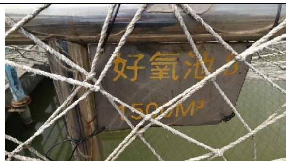
废水处理站好氧池 B
