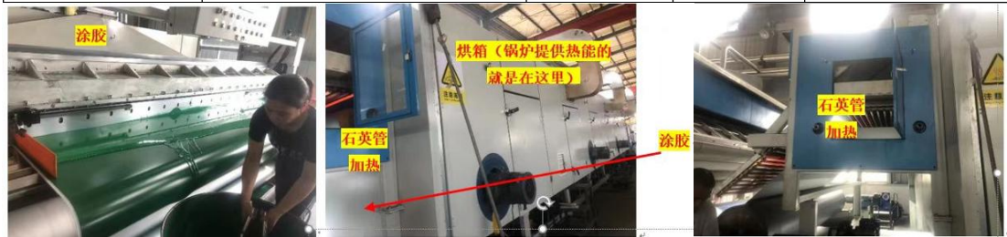
图 2-1 项目多功能 PVC 涂层机设备生产线
