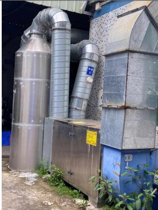
焊接废气处理设施
