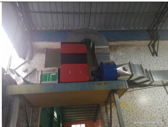
喷粉、分条废气处理设施
