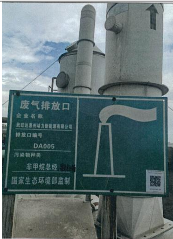
2 栋注液废气排放口 2(DA005)
