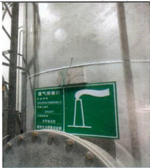
15A 栋 NMP 废气排放口(DA007)
