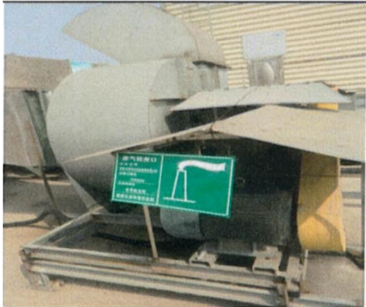
3 栋 NMP 废气排放口 2（DA002）
