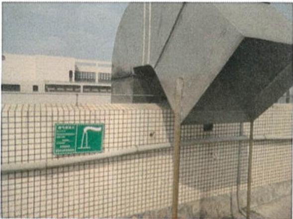
3 栋 NMP 废气排放口 1（DA001）
