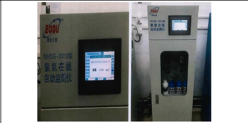
废水氨氮在线监测系统设备
