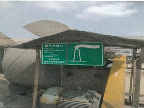
3 栋 NMP 废气排放口 3（DA003）
