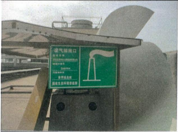
3 栋 NMP 废气排放口 4（DA004）
