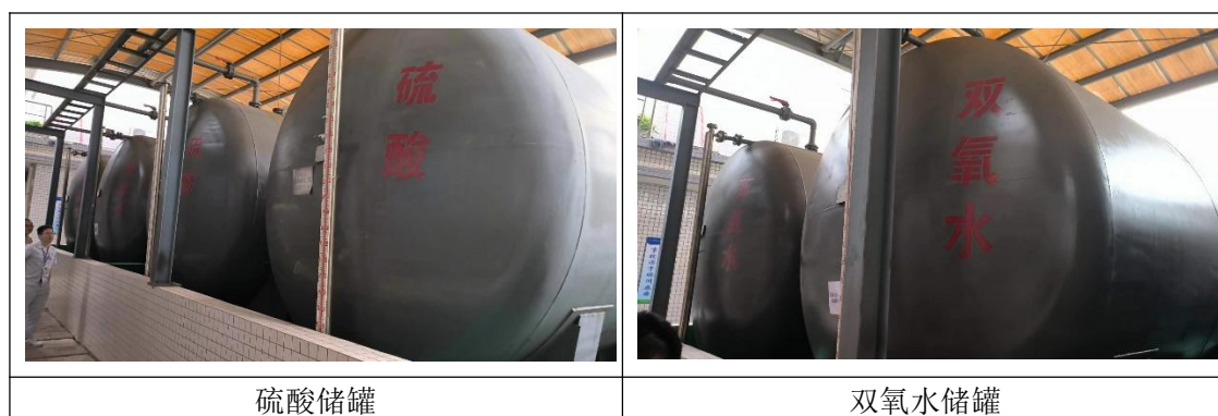
图 3.3-3 厂区接地储罐照片
