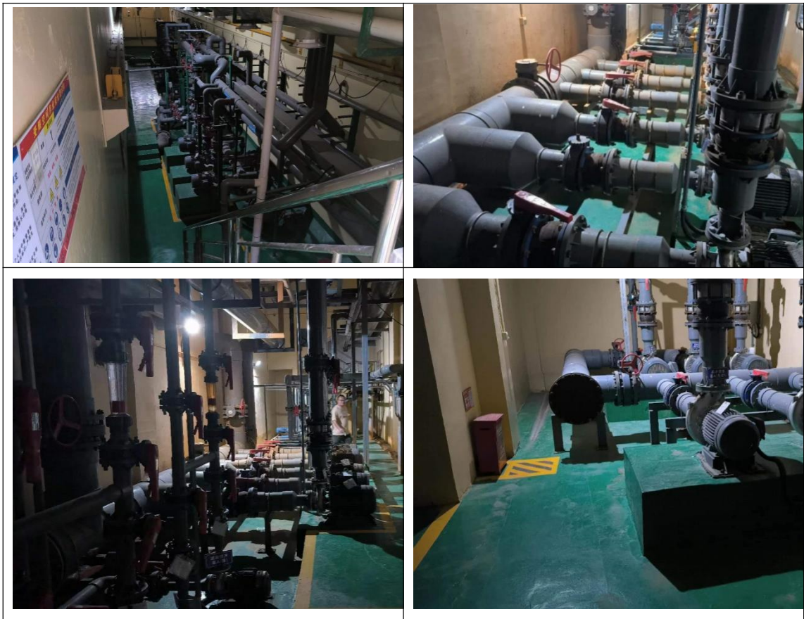
图 3.3-7 传输泵现场图片
