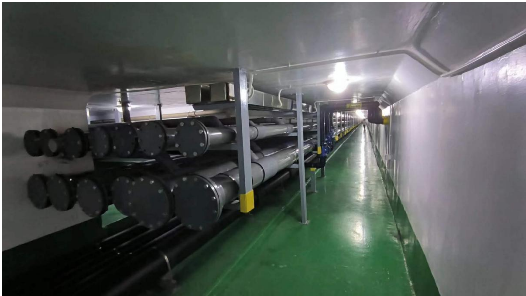
地下污水管道管廊
